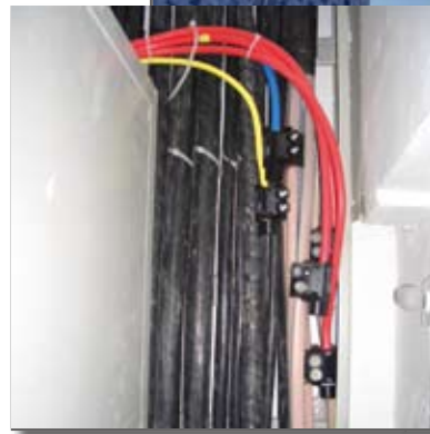
建筑配电分支
